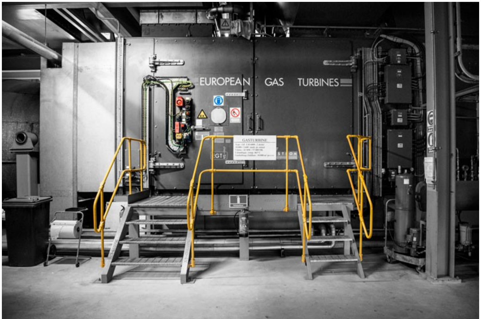
Foto: Den højtydende gasturbine lavede engang strøm og varme i daglig drift men bruges nu kun som backup.
