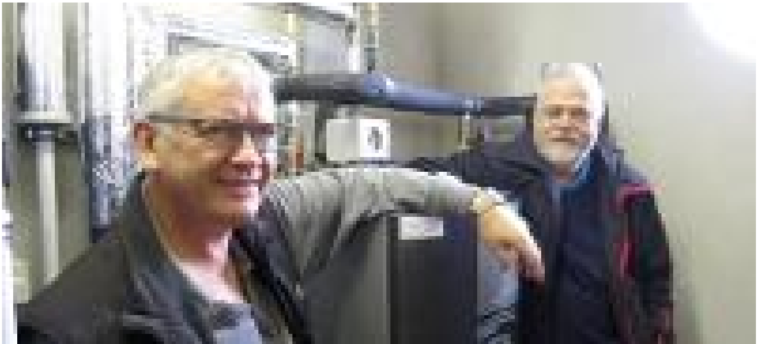
Arne Hadberg (tv), Broager VVS har dimensioneret og installeret anlægget i samarbejde med Rainer Carstens fra Alpha Innotec.
