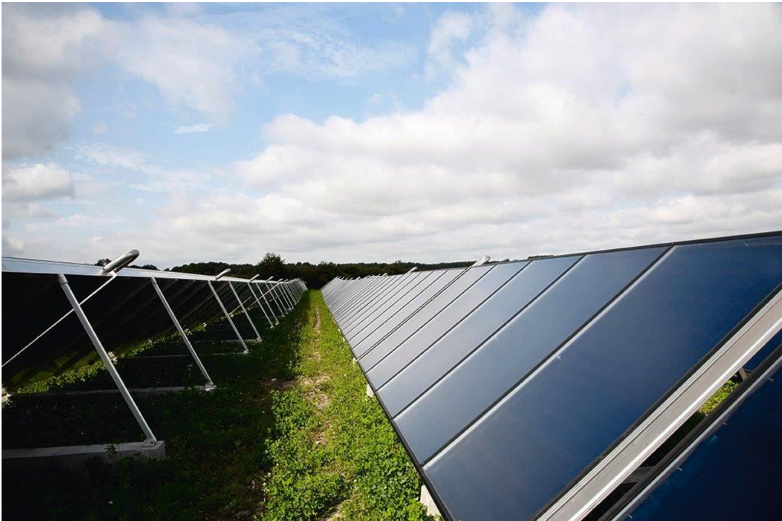
Solfangere hos Gråsten Fjernvarme
